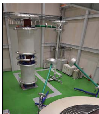
【図5】 CV ケーブル残存耐電圧 性能評価に活用する 絶縁特性試験設備
