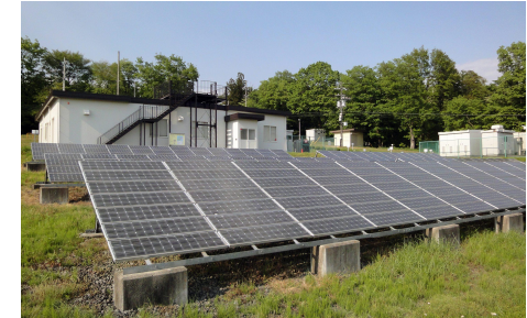
需要地系統ハイブリッド実験設備※1
