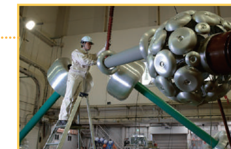
CVケーブル絶縁特性試験設備
