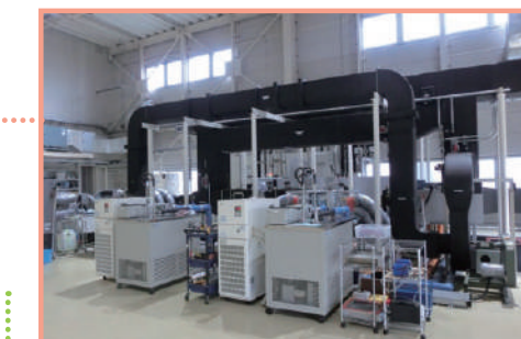
ヒートポンプ用空気熱交換器試験設備
