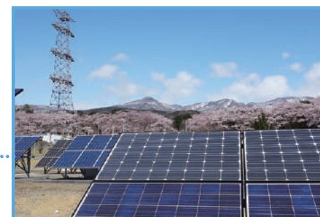
太陽光発電試験設備
