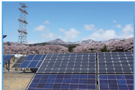
太陽光発電試験設備
