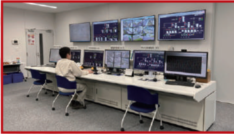
需要地系統ハイブリッド実験設備
