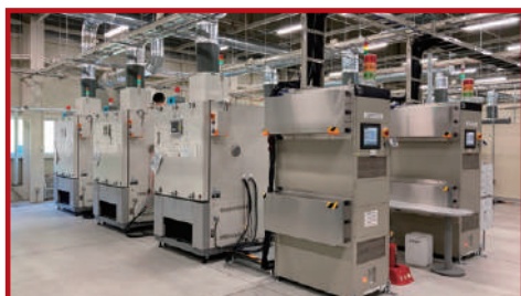
二次電池評価試験設備
