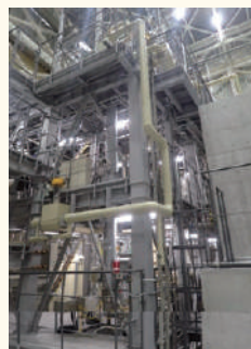
軽水炉三次元熱流動実験設備
