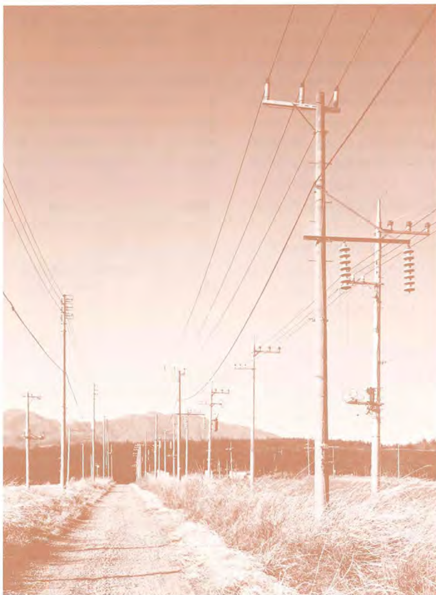
赤城試験センターの実験用配電線
