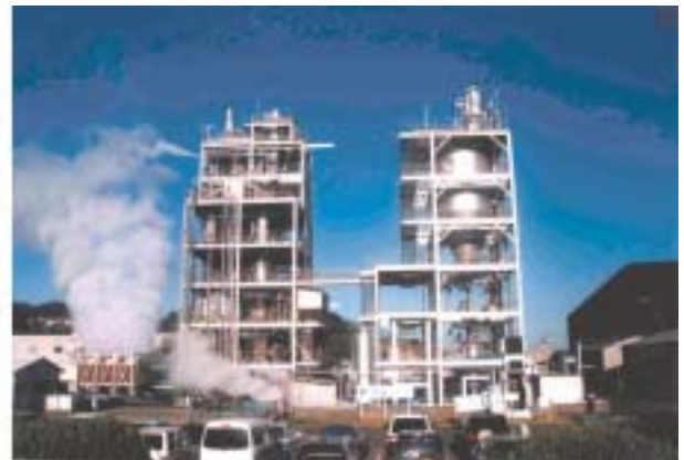
図2-1-2 24トン/日ガス化試験装置
