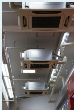
ビル用空調設備
