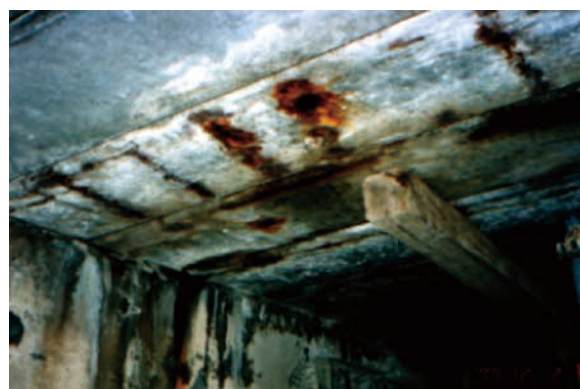
栈橋の塩害劣化
