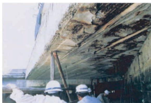
道路橋の塩害劣化
