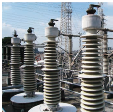
変電所のブッシングがいし
